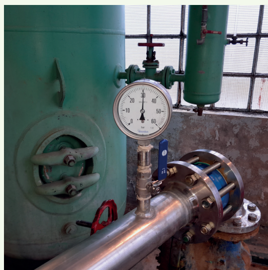
Station de pompage de Clermain (SIE Haute Grosne)
