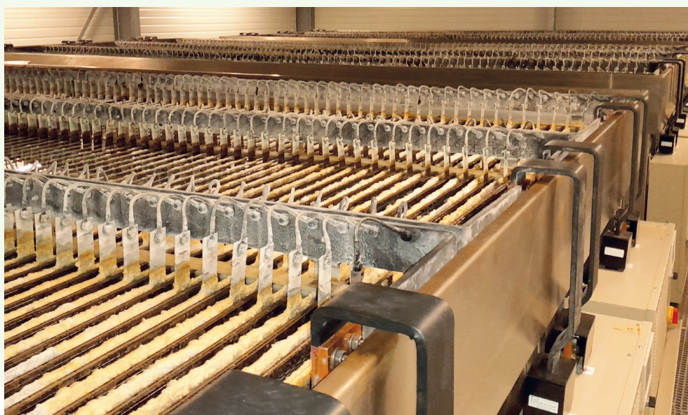
Station de traitement d'Allerey-sur-Saône (Bacs de décarbonatation)
