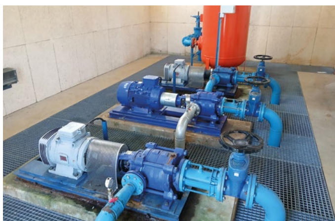
Station d'interconnexion de Clermain, permettant de faire remonter l'eau issue de la Saône vers le Charollais
