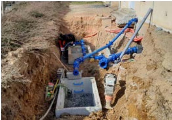
Regard de régulation hydraulique à l'arrivée de l'interconnexion à la station de Baugy
